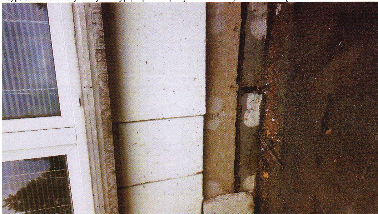
Zdjęcie nr 2 elewacji budynku typu Lipsk na połączeniu z budynkiem tzw. łącznikiem
